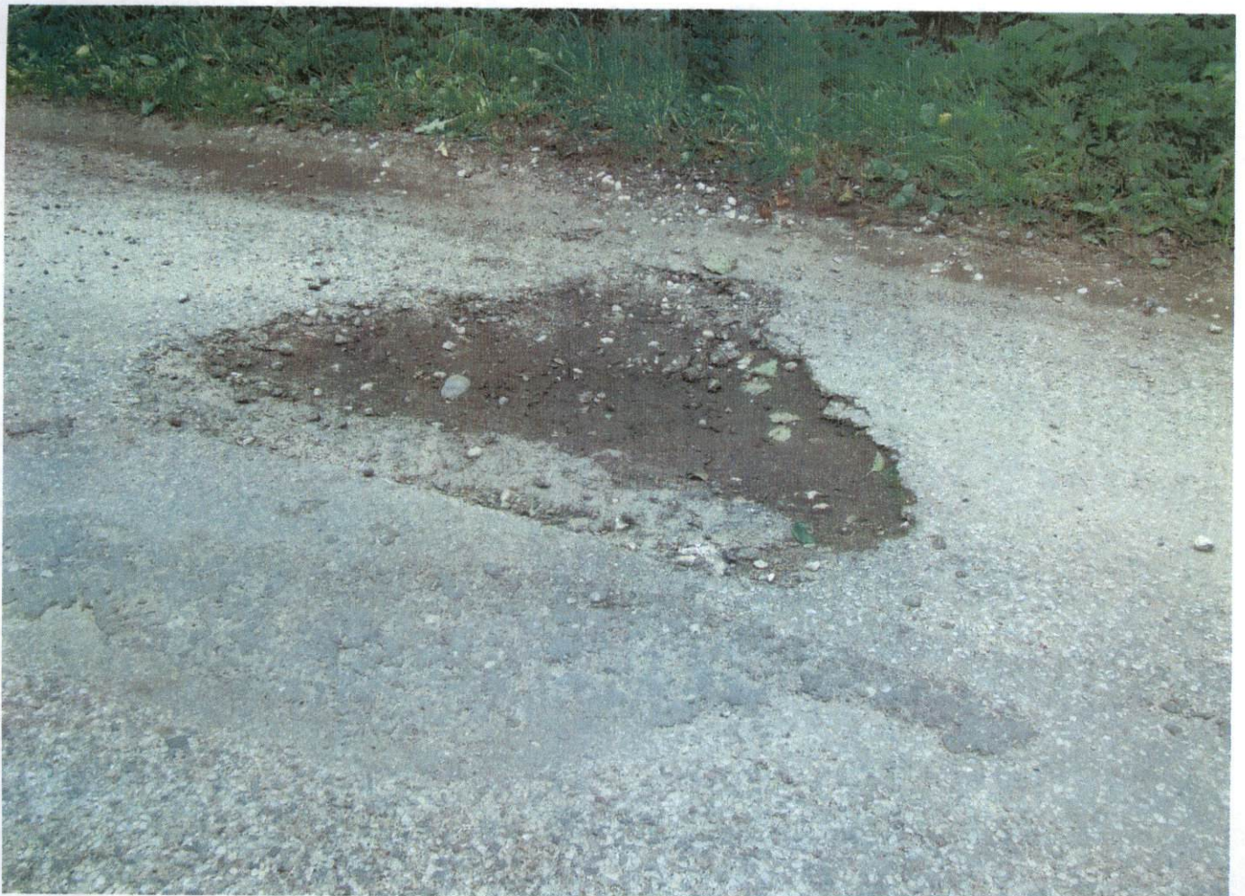
UBYTKI NA ODCINKU DROGI OD STRONY WSI
